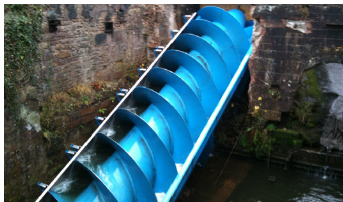
Trois vis hydrodynamiques de ce type seront installées.
