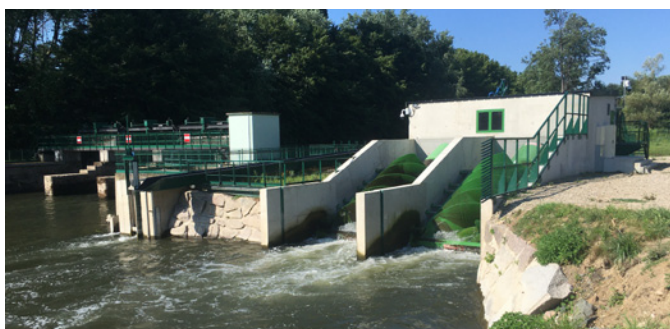
Une petite part (10%) de l'hydroélectricité produite par les deux turbines du barrage d'Ebnwibr alimente près de 90 % des besoins de la Commune.
